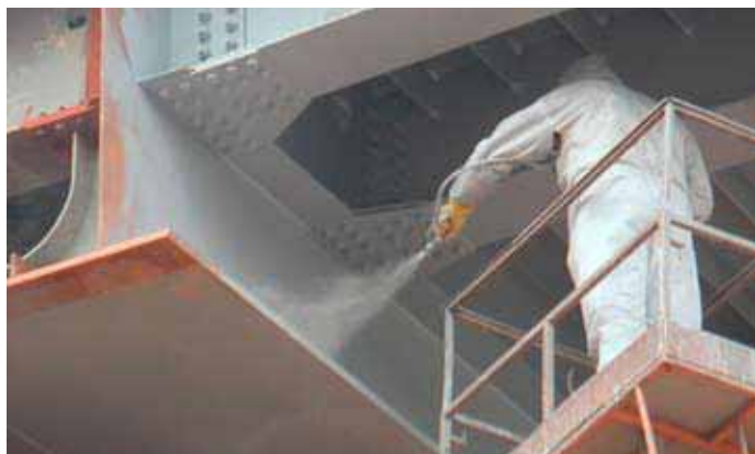
Нанесение грунтовки ЦИНТАН в полевых условиях. Пешеходный мост к храму Христа Спасителя, г. Москва.
